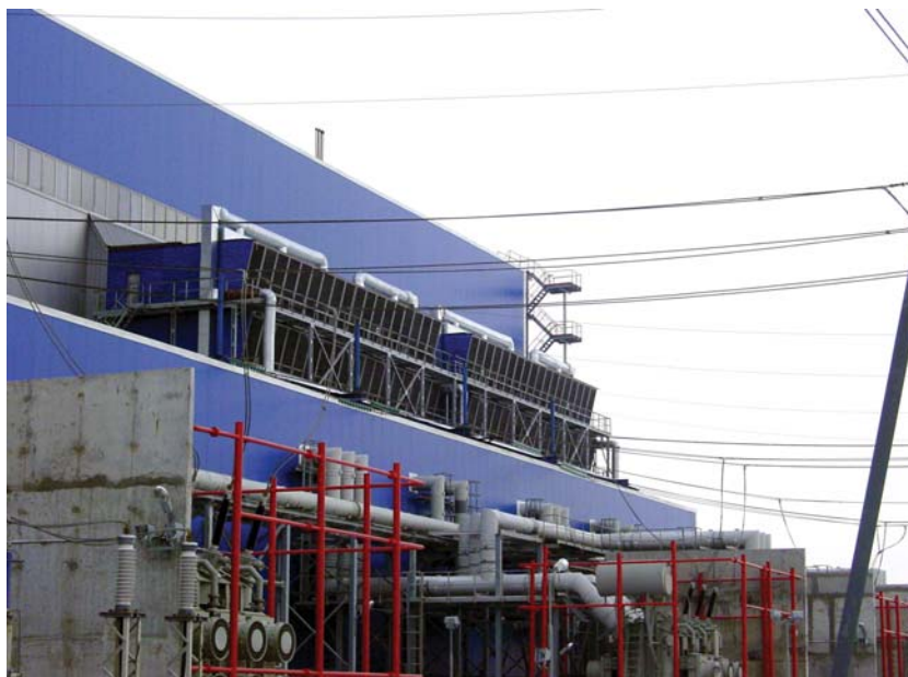
Рис. 1.1. КВОУ энергоблока Калининградской ТЭЦ-2
