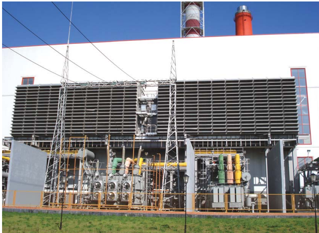
Рис. 5.36. КВОУ ГТУ и силовые трансформаторы энергоблока ПГУ
