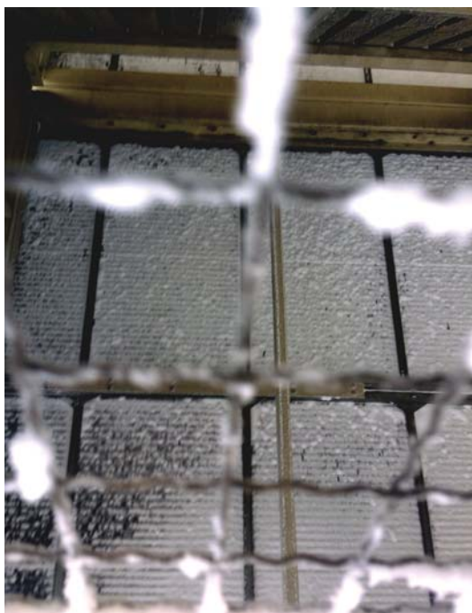
Рис. 2.76. Теплообменный аппарат КВОУ ГТУ, обледеневший и занесенный снегом
