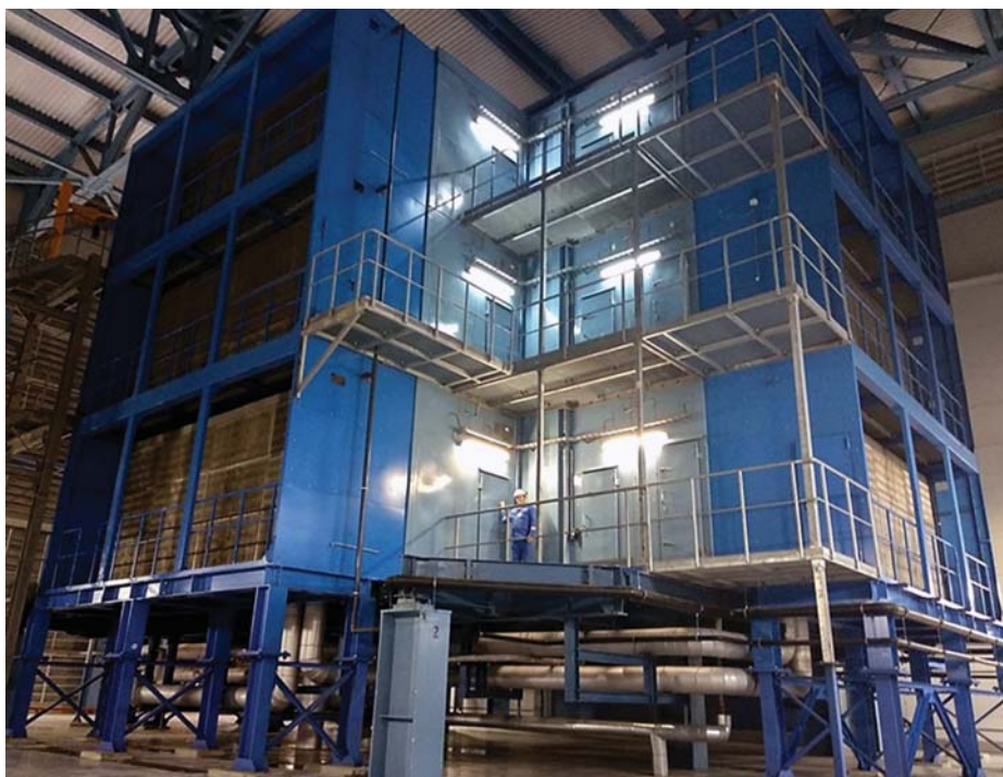
Рис. 2.2. КБОУ ГТУ Siemens SGT5-4000F ТЭЦ в ЮЗАО Москвы
