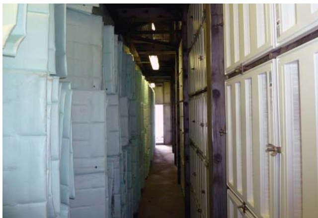
Рис. 4.22. Двухступенчатая система фильтрации КВОУ ГТУ-32 ТЭЦ в МО
