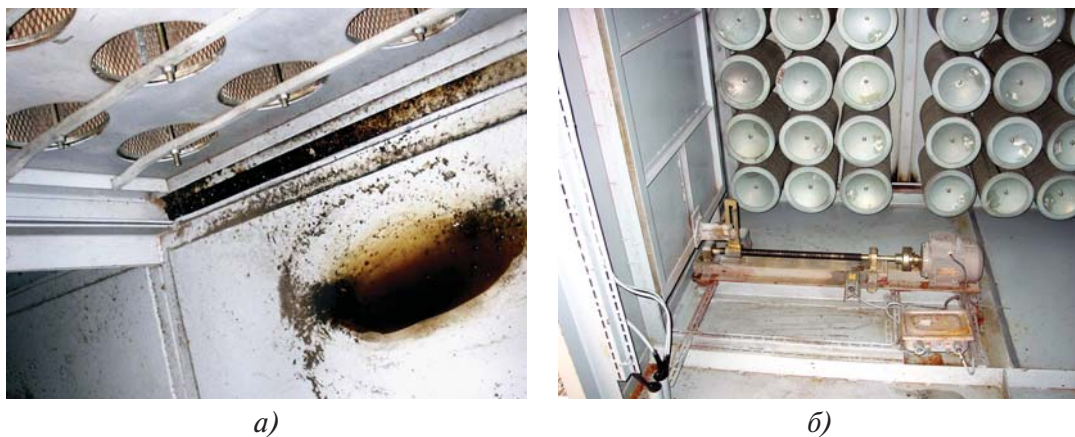
Рис. 1.4. Блок фильтров тонкой очистки: а) подвод воздуха к ФТО; б) ФТО и привод байпасных клапанов
