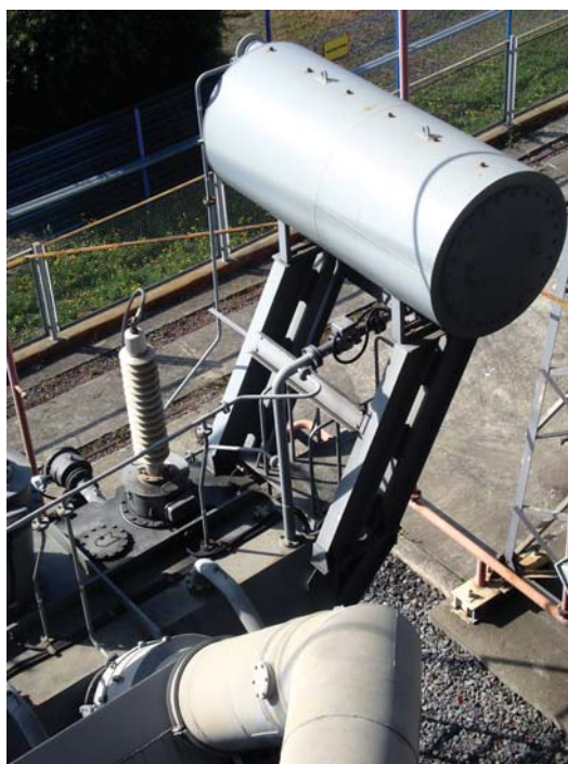
Рис. 5.37. Масло на поверхности силового трансформатора под маслобаком
