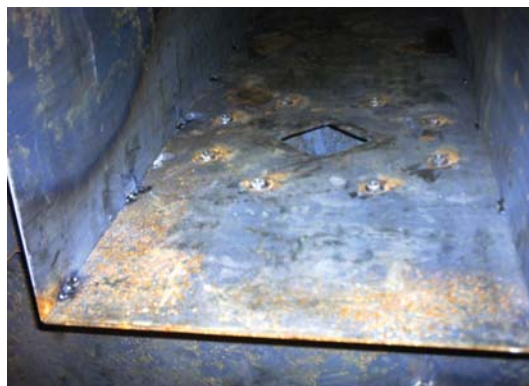
Рис. 1.16. Внутреннее состояние коробки ПОС КВОУ
