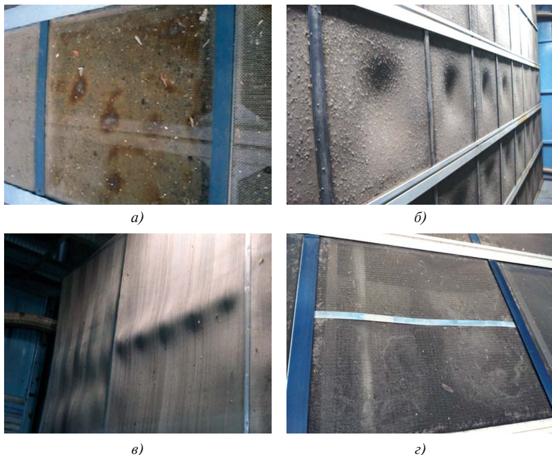
Рис. 2.40. Конструктивные неисправности противомоскитных сеток: а) ржавление металла; б), в) деформация металла; г) двойная сетка [9]
