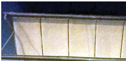
Рис. 2.45. Обмерзание защитных сеток от птиц и мусора КВОУ ГТУ
