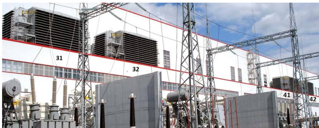
Рис. 5.19. КВОУ № 31 и 32 энергоблока № 3 и КВОУ № 41 и 42 энергоблока № 4 ТЭЦ в МО
