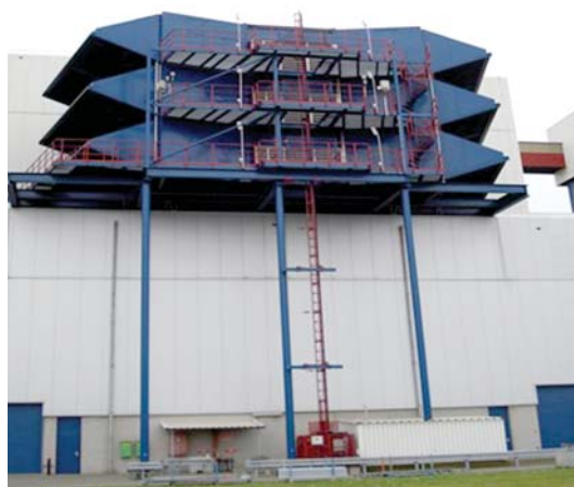
Рис. 2.6. КВОУ компании Merrem & la Porte на ТЭЦ Delesto [3]
