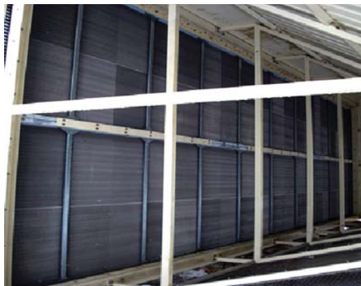
Рис. 2.75. Теплообменный аппарат в КВОУ ГТУ
