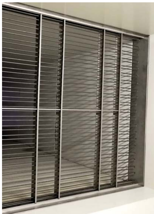
Рис. 2.81. Электрическая АОС в КВОУ ГТУ Siemens SGT-300
