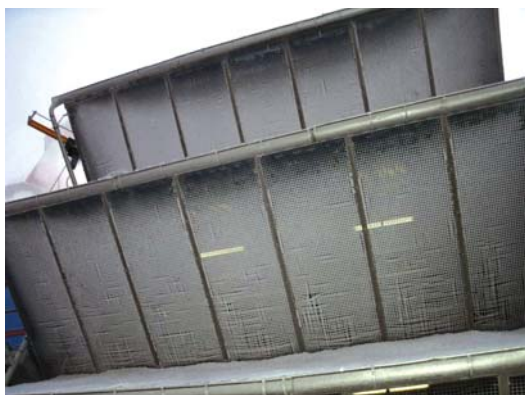
Рис. 2.49. Обмерзание защитных сеток от птиц и мусора КВОУ ГТУ Яйвинской ГРЭС [15]
