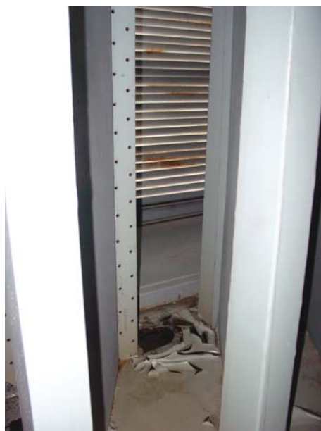
Рис. 1.2. ПОС и входные жалюзи КВОУ ГТЭ-160
