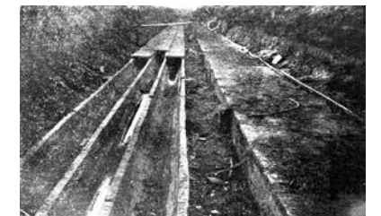
1-я ТЭЦ МОГЭС. Трехтрубные каналы: справа – к Автосборочному заводу, слева – к Шарикоподшипникстрою.
