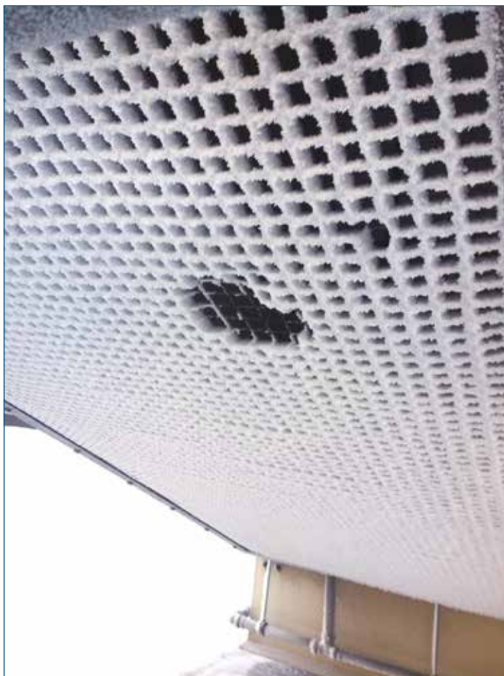
Рис. 12. Обмерзание защитной сетки от птиц КВОУ ГТУ
