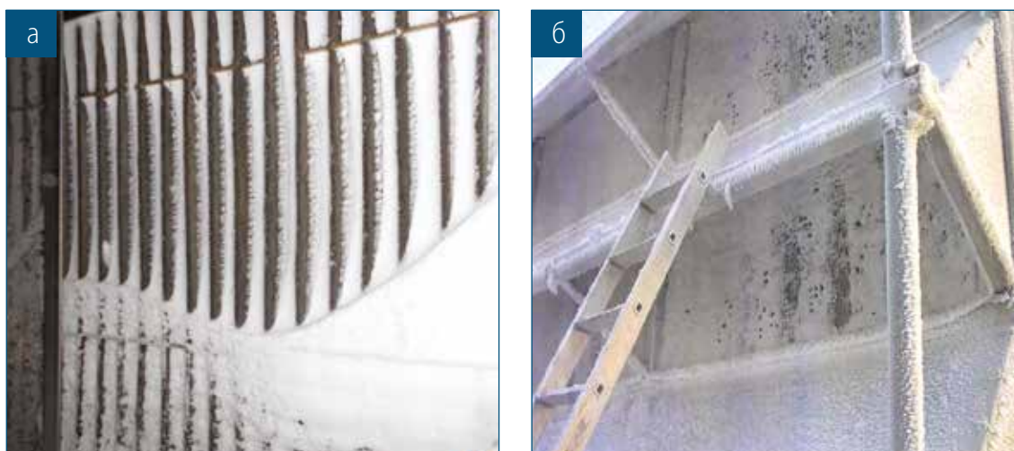
Рис. 9. Последствия использования противомоскитных сеток зимой: а – скопление снега между сеткой и фильтром; б – обмерзание и блокирование противомоскитных сеток и всаса КВОУ
