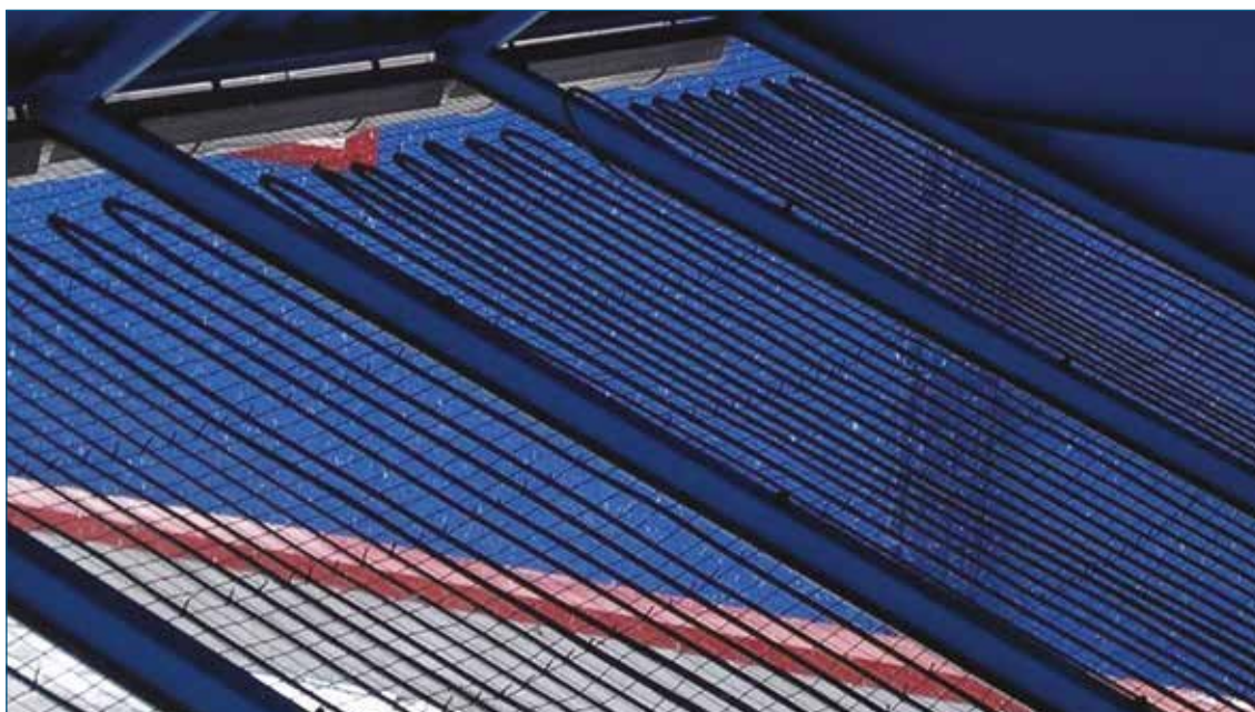
Рис. 16. Саморегулирующийся греющий электрический кабель в КВОУ ГТУ ГРЭС
