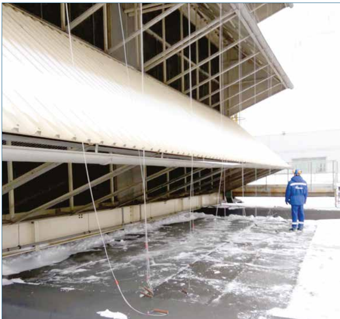
Рис. 21. Очистка защитных сеток от птиц и мусора КВОУ методом стряхивания
