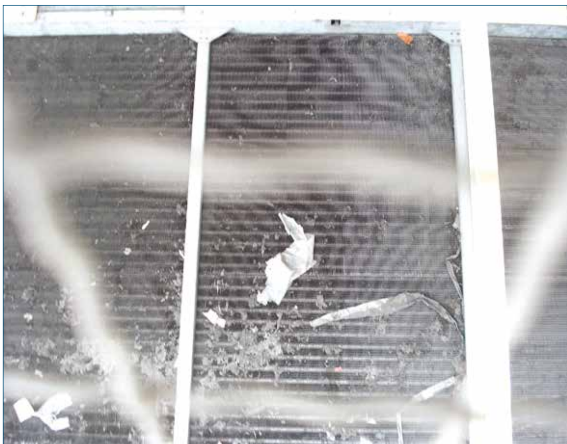
Рис. 3. Загрязнение теплообменного аппарата КВОУ ГТУ мусором
