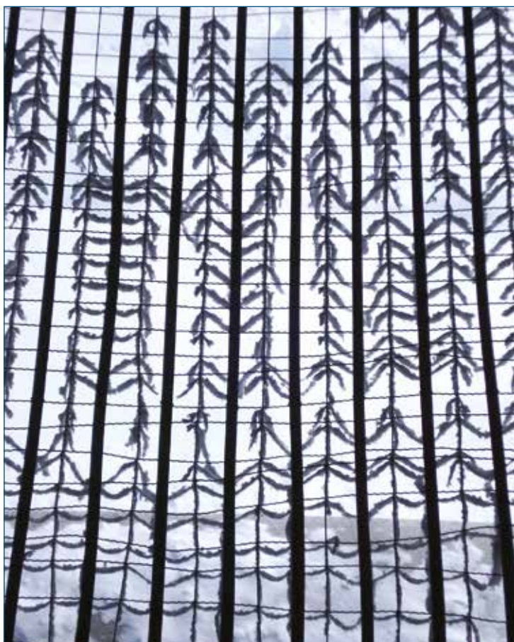
Рис. 17. Обмерзание защитной сетки от птиц и мусора при работающем электрокабеле
