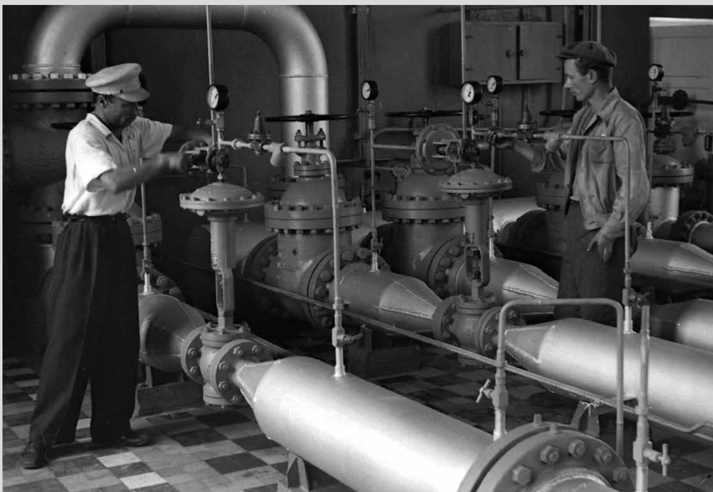
Отделение контрольно-измерительных приборов в газораспределительной станции № 1 газопровода Саратов – Москва, 1940-е годы
