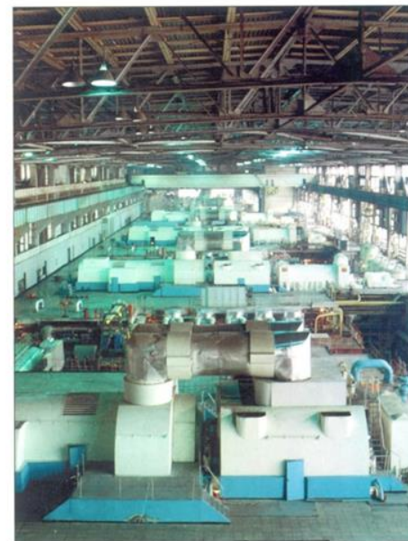
Машинный зал с турбинами Т-250 Turbine hall with T-250 turbines
