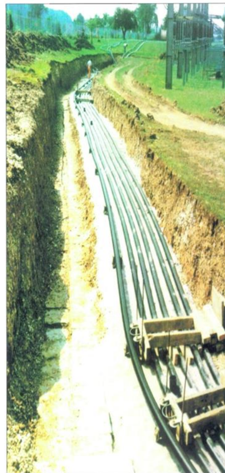
Участок кабельной трассы Cable route section
