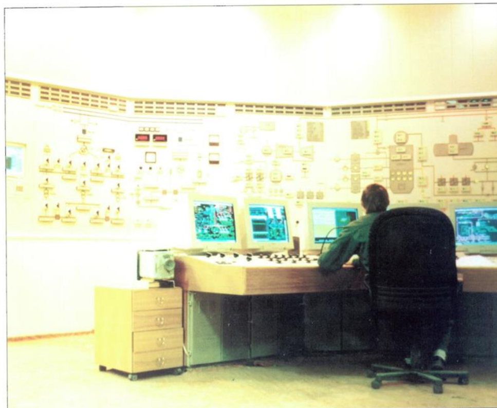
Щит управления ТЭЦ / Control panel of power plant
