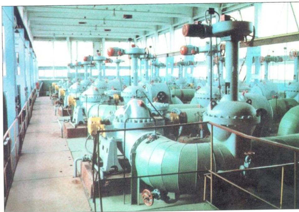
Насосно-перекачивающая станция Pump station
