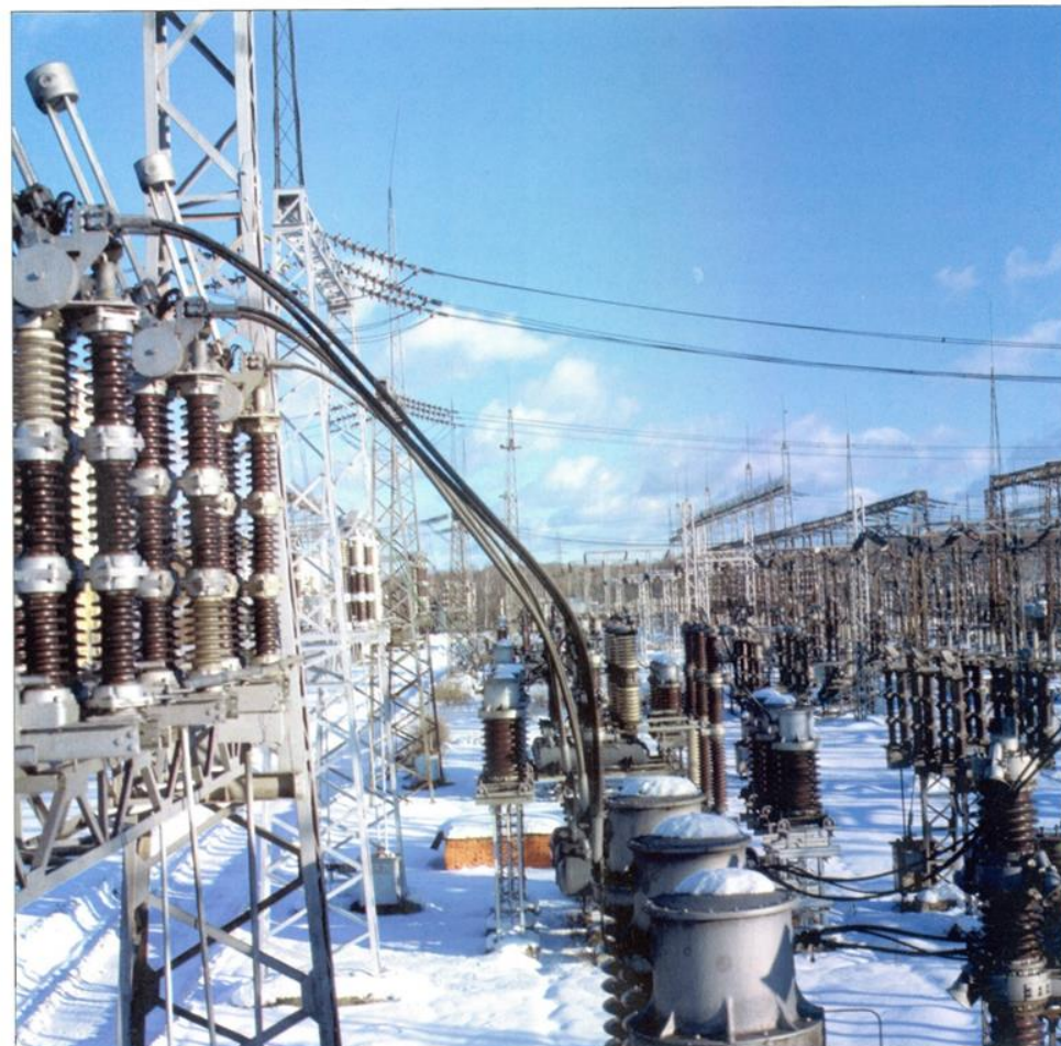
Электростанция открытого типа Exposed-type substation
