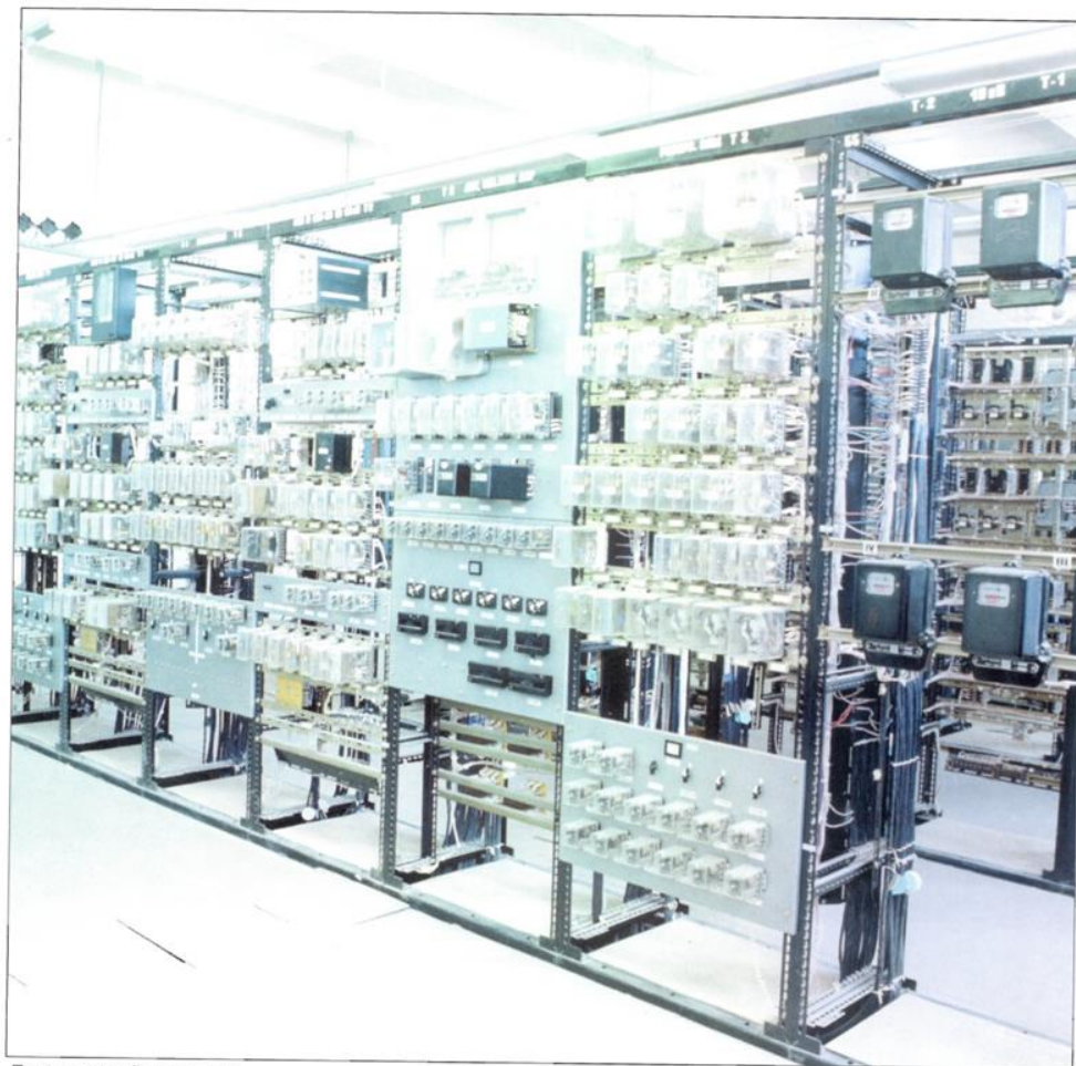
Панели релейного щита Relay panel
