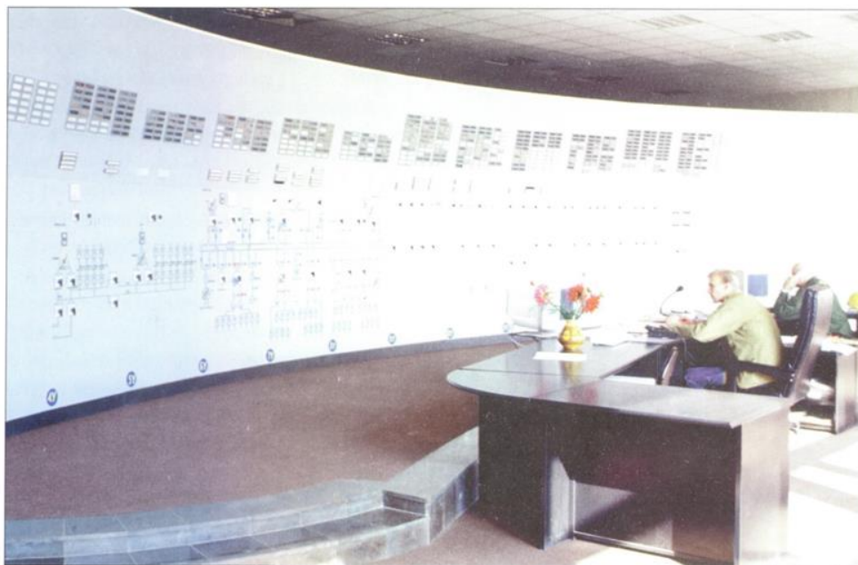
Блочный щит управления ТЭЦ-27 / Block-type control panel of TEP-27
