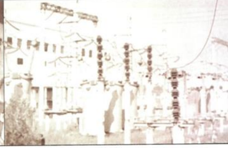
Электроподстанция на 220 кВ 220 kV substation
