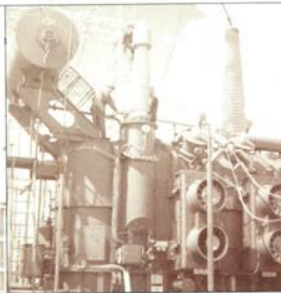
Трансформатор на 500 кВ 500 kV transformer
