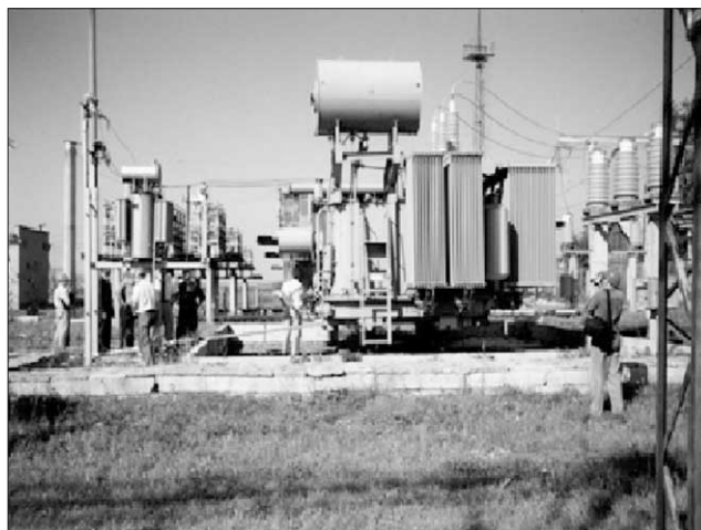
Рис. 6. Управляемый подмагничиванием реактор типа РТУ-25000/110 на подстанции Кудымкар
