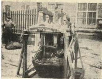
11. Вид выключателя Измайловской подстанции 33 кв. после аварии.
