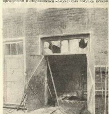
Рис. 10. Наружный вид ячейки выключателя Измайловской подстанции 33 кв. после аварии.
