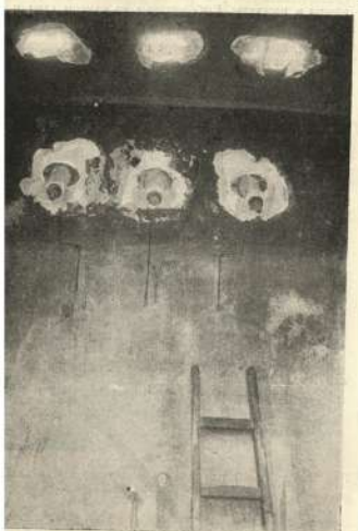
12. Внутренний вид камеры выключателя Измайловской подстанции 33 кв. после аварии.
