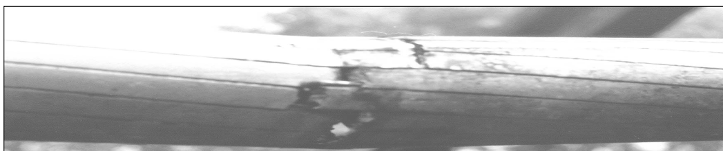
Рис. 1. Усталостное разрушение провода ПА 640 в результате ветрового воздействия
