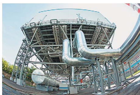
Сухая вентиляционная градирня, использование которой позволяет минимизировать воздействие на окружающую среду
