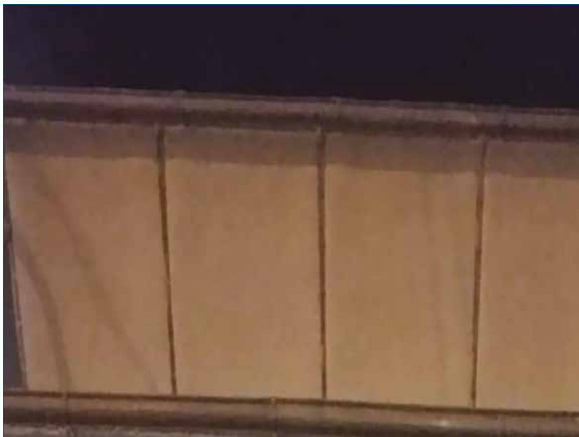
Рис. 5. Обмерзание защитных сеток от птиц и мусора КВОУ ГТУ
