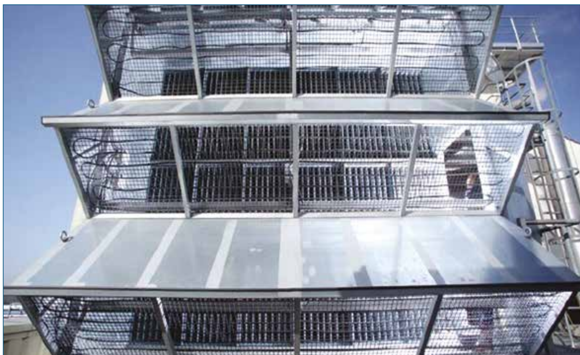
Рис. 18. Саморегулирующийся греющий электрический кабель в КВОУ ГТУ Solar Taurus 70
