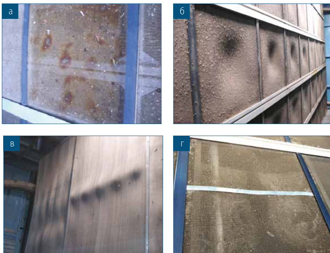
Рис. 10. Конструктивные неисправности противомосkitных сеток: а – ржавление металла; б, в – деформация металла; г – двойная сетка
