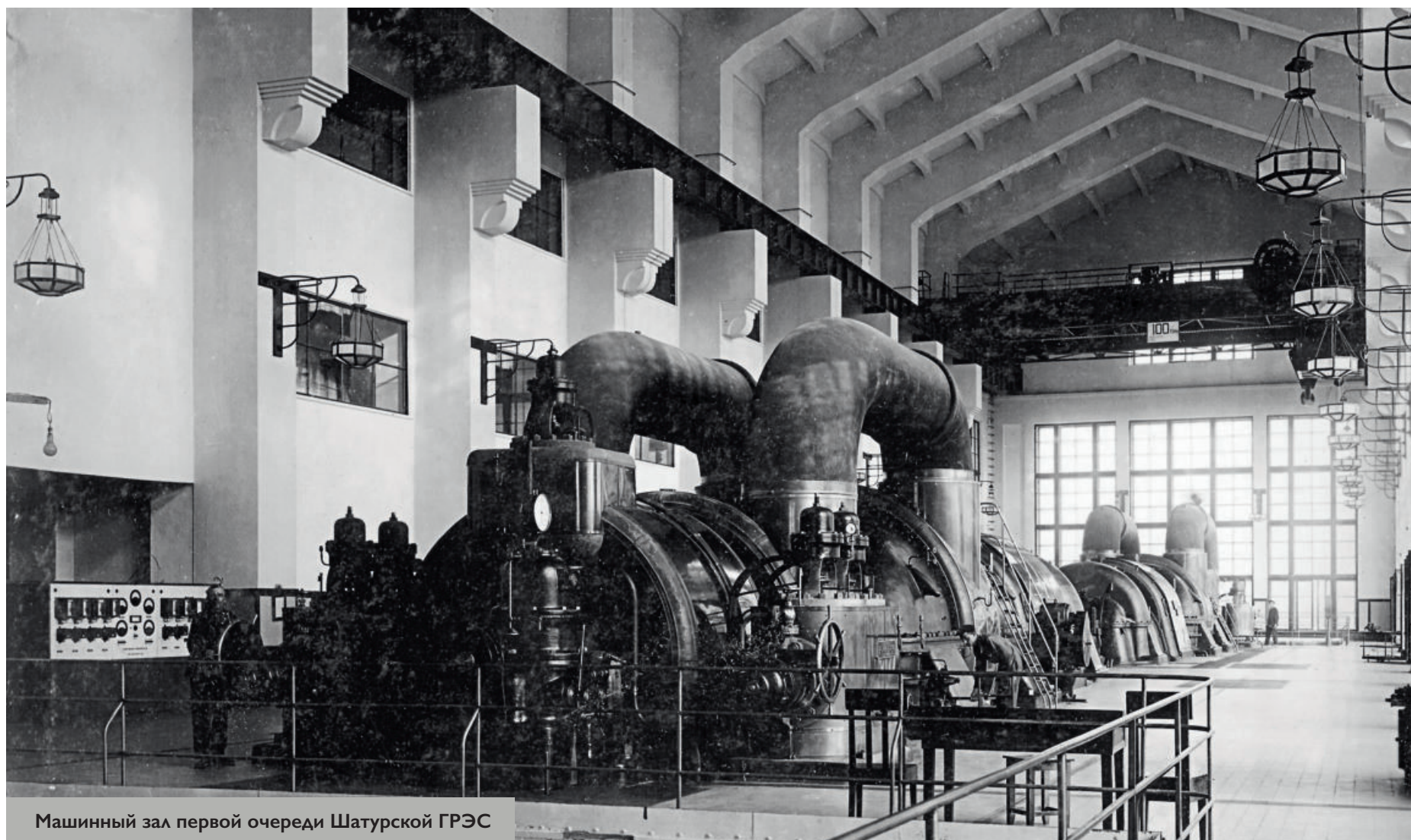
Машинный зал Шатурской ГРЭС
