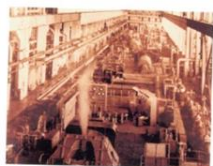
Машинный зал котло-турбинного цеха (22 декабря 1952 г. – 01 мая 1982 г.)
