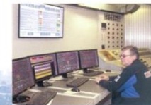
Щит управления блока №7 2016 г.
