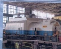
Турбогенератор №8 ЛТ-116/125-130-2 (2016 г.)
