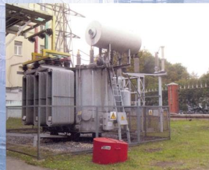
Трансформатор 10/110кВ, 40МВА (2016 г.)
